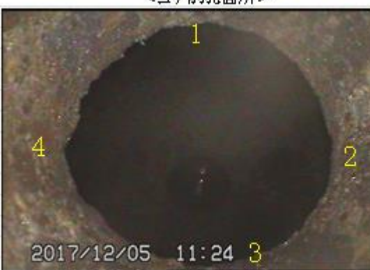
<コア内部状況(空洞部)>
